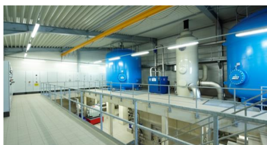
Aufbereitungsanlage Embken von innen
